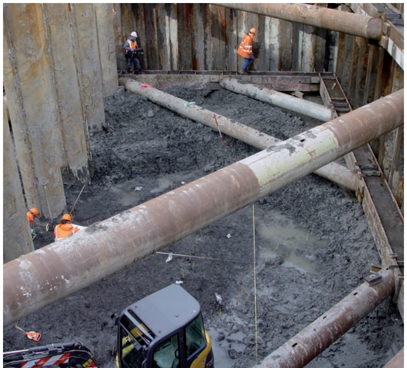
Afb. 10. Rotterdam Markthal. Impressie van het intensieve heiwerk in de bouwkuip (linksboven, vanuit het oosten). Impressie van het eerste en tweede stempelraam in put 4 (rechtsboven, vanuit het zuid-westen). De vier hoeken van de damwandenput zijn geschoord met stempels (onder, vanuit het zuiden); hier zijn tevens de buispalen te zien, op de grens van put 4a en 4b.
